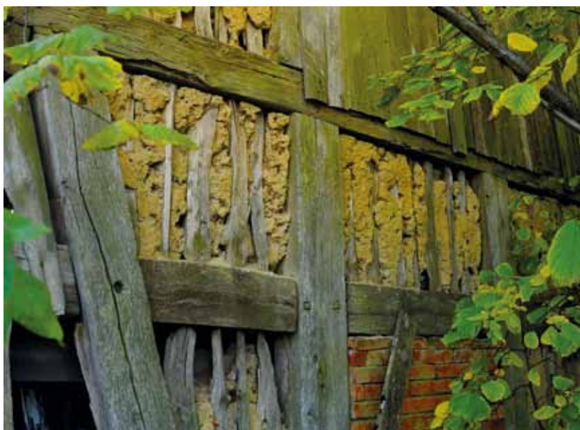
Fot. 13. Wieś Nowe Kurowo. Zniszczony strychulec
